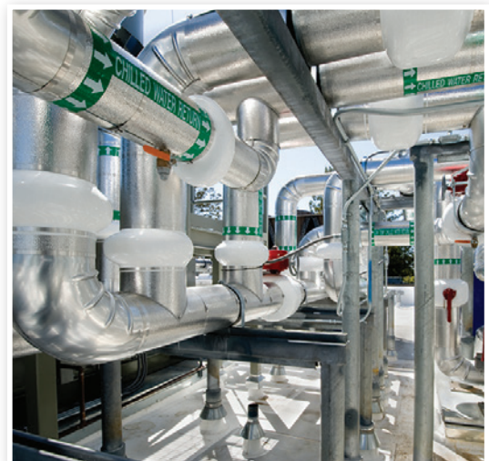
En algunos lugares grandes se usan sistemas de refrigeración o calefacción centralizados que requieren una red de tuberías para el paso del agua o el aire. Para que esto funcione óptimamente, las tuberías están cubiertas de materiales aislantes para que el agua o el aire mantenga lo mejor posible su temperatura.
